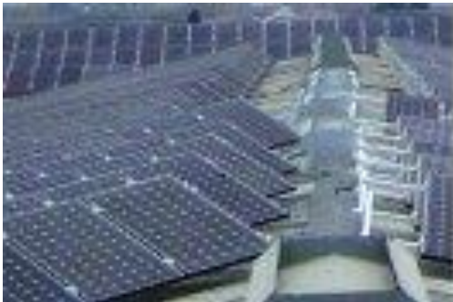
Cubierta Potencia Total: 1,4 MW (1,61 MWp)
