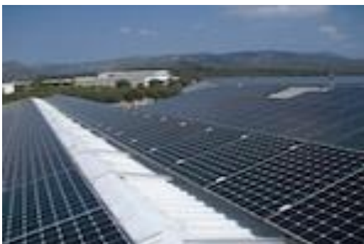
Cubierta Potencia Total: 1,52 MW (1,77 MWp)
